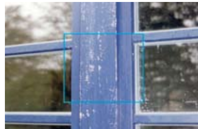
Oštećenje boje zbog primjene prejake ljepljive trake od tkanine.
